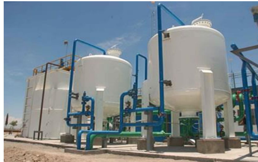
Clarificación - Filtración avanzada
