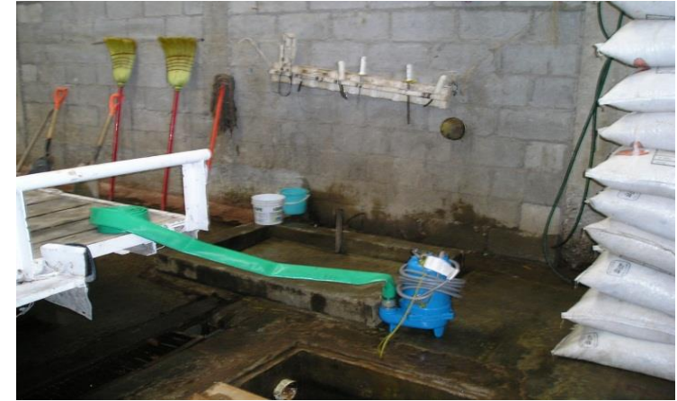
Canalización de descargas peligrosas a tanques de confinamiento.
